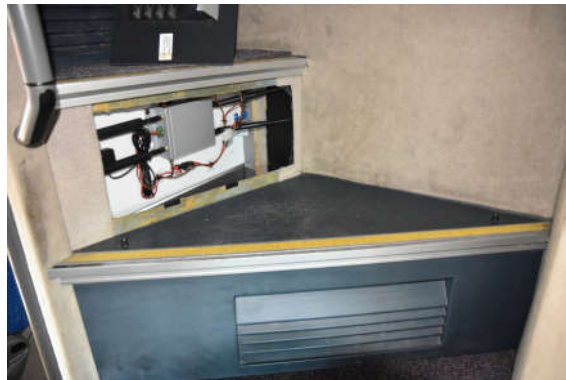
In der Bustreppe eingebaute WLAN Lösung: VH760 mit LTE und MIMO Antennen
